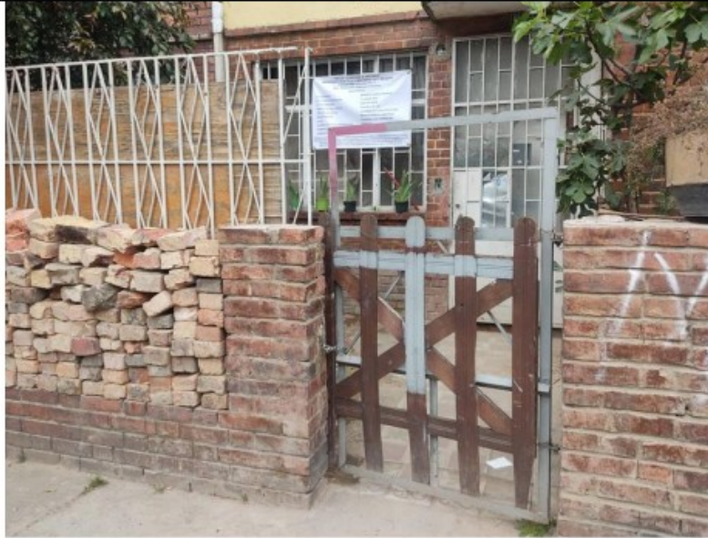
Fotografía 5 – Se observa cerramiento del antejardín del predio ubicado en la Carrera 16 A No. 48-56/52. (Fecha de toma de la imagen 19 de julio de 2021 ).
