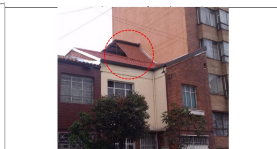
Fotografía 4 – Desde el exterior al costado occidental de la Carrera 16A, se alcanza a observar la modificación del material de cubierta original del inmueble, de la elevación en altura de la fachada respecto a su colindante por el costado izquierdo y de la elevación de un volumen en la parte interna del predio; intervenciones realizadas sin autorización de IDPC ni de curaduría urbana. (Fecha de toma de la imagen 06 de septiembre de 2022).
